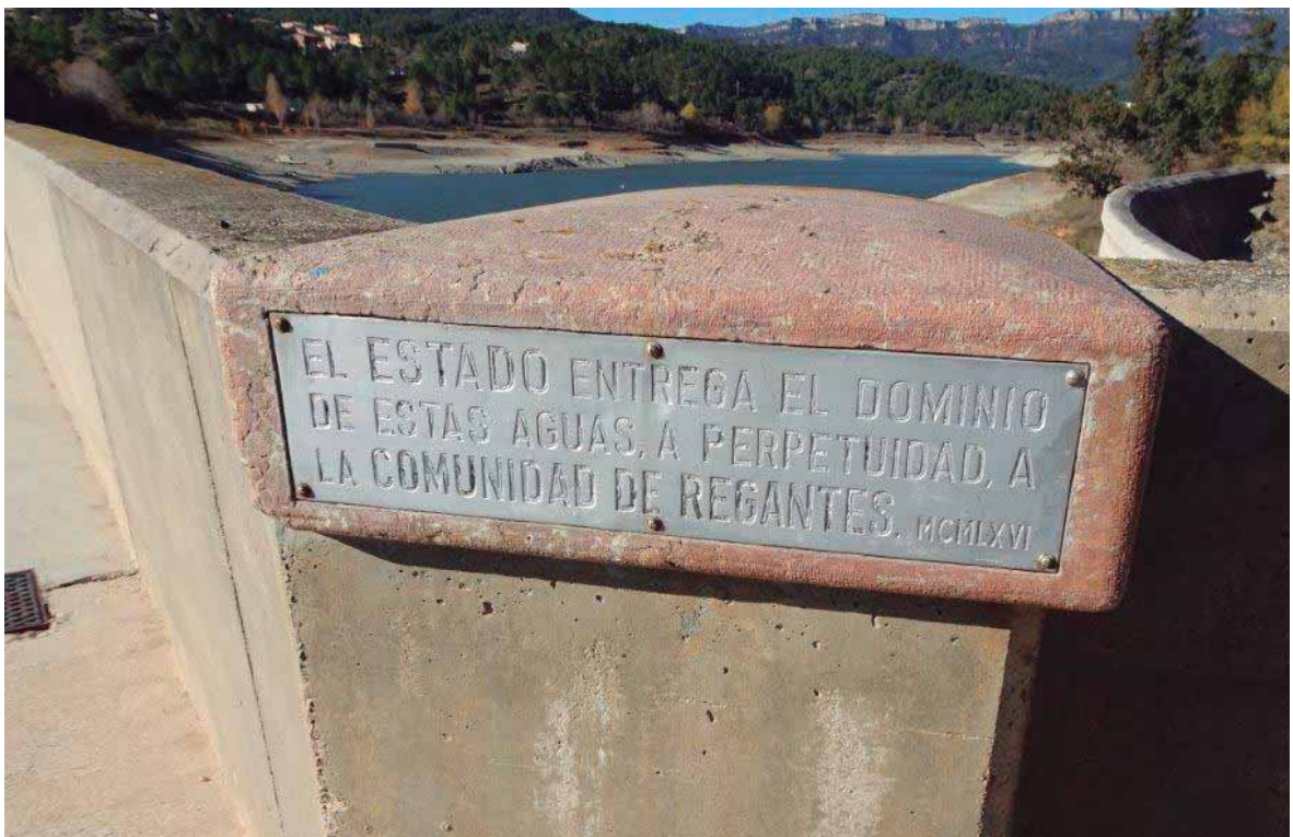
Placa existente en la pared de la presa del embalse de Riudecanyes, cuyo contenido es contrario a lo establecido en la Ley de Aguas.
