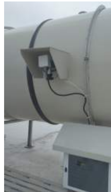
Sensor de emisiones en chimenea del biofiltro. Autor: FRAVM
