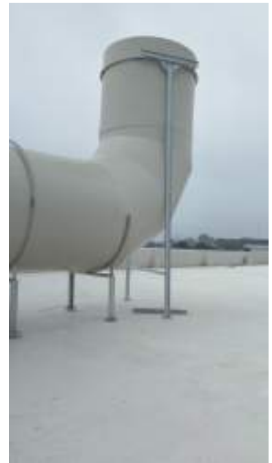
Chimenea del biofiltro. Autor: FRAVM
