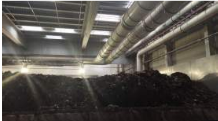
Extractores zona de compostaje. Autor: FRAVM
