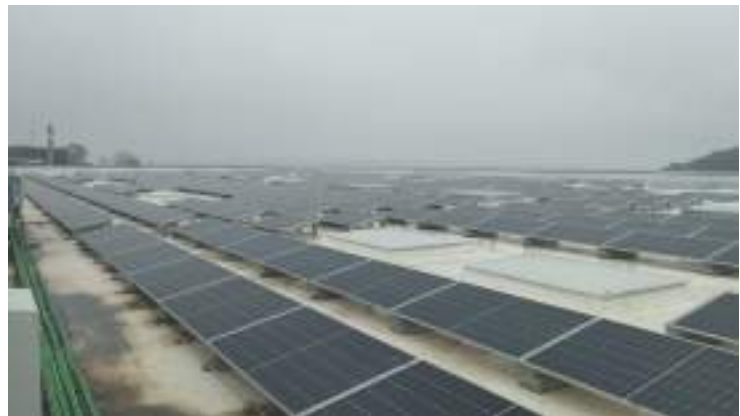
Instalación fotovoltaica. Autor: FRAVM
